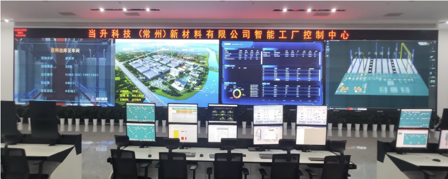
常州当升智能工厂控制中心
